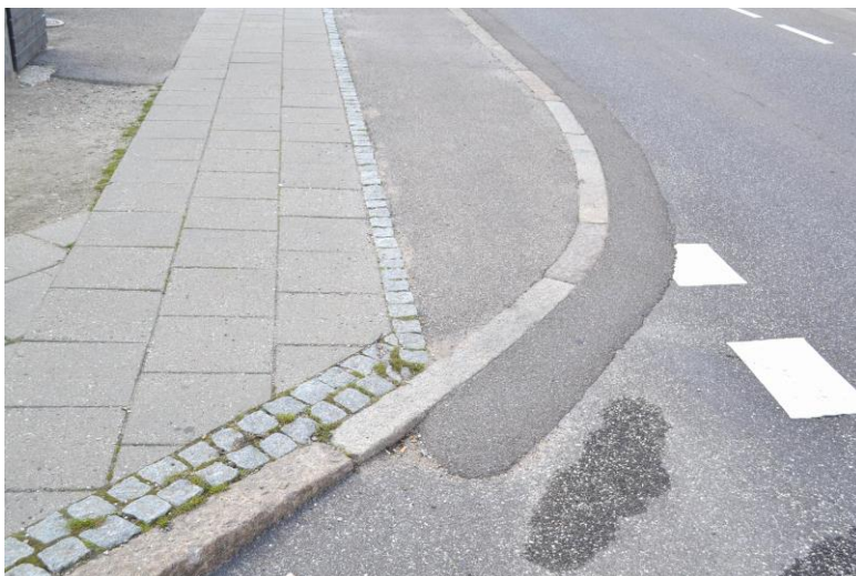
Stejl og med sidehældning! Nedkørsel fra cykelsti på Kalundborgvej
